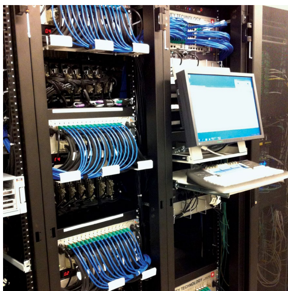
Vattenfalls system room
