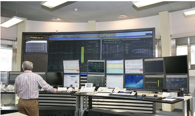
Neue Energie- und Netzleitstelle im Einsatz
